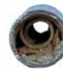
Rohrleitung 10 Jahre alt
